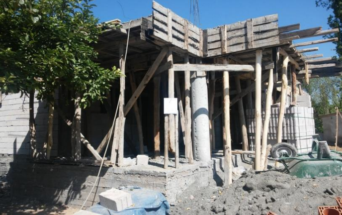
Kaçak yapılaşma ile ilgili yapılan çalışmalar
