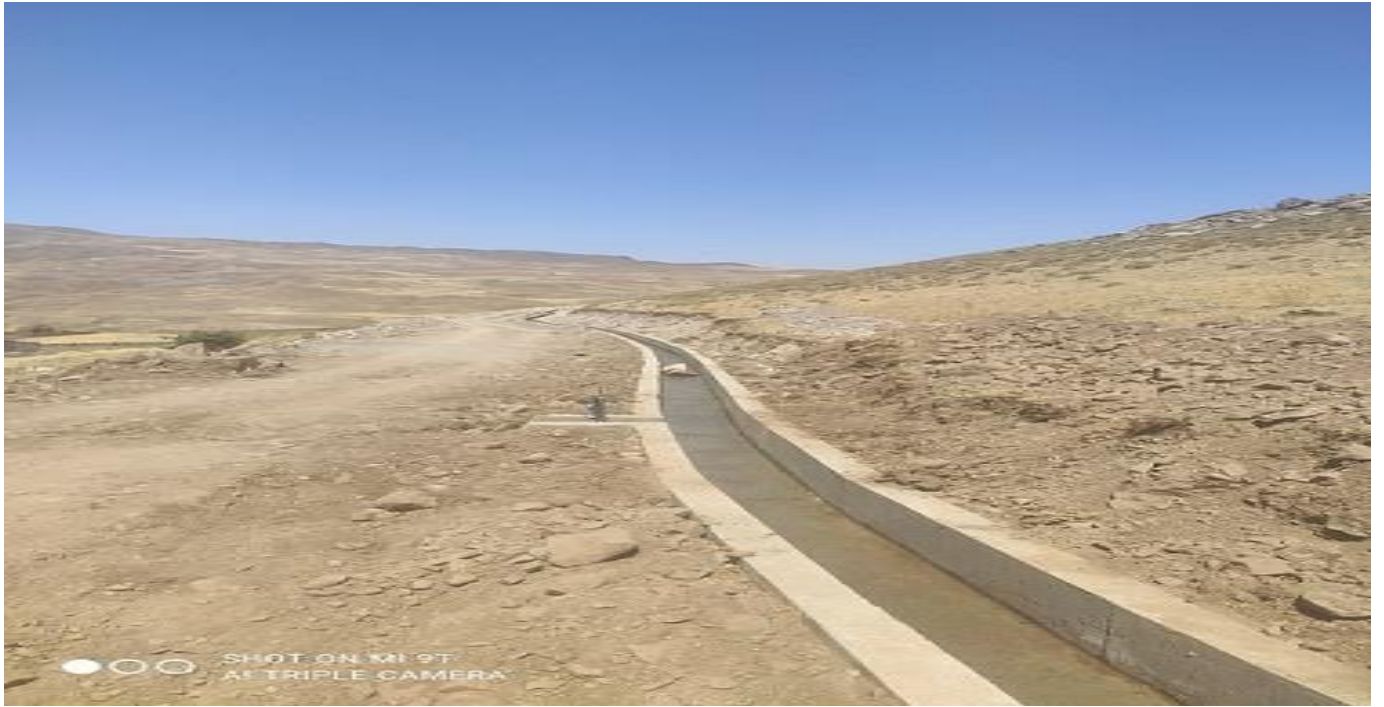
Badıllı Köyü Sulama Tesisi
