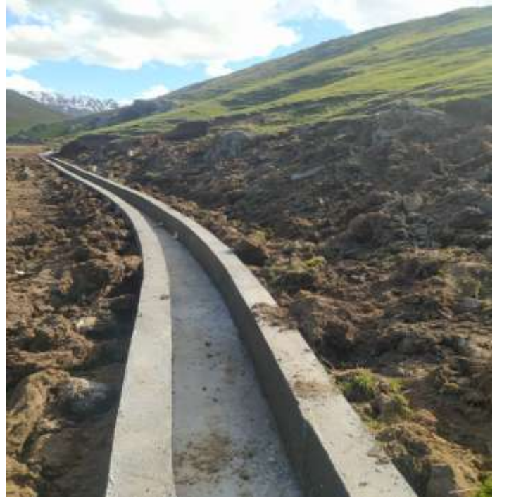
Gedikli Köyü Sulama Tesisi
