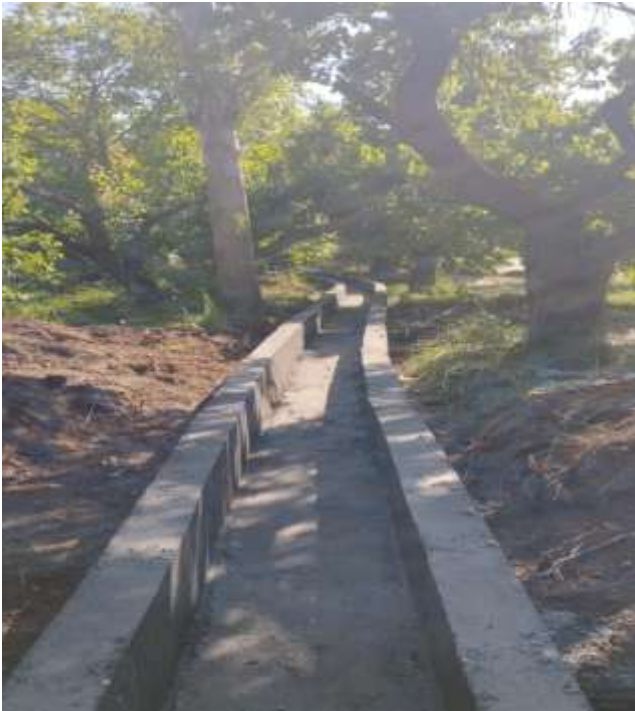
İncesu Köyü sulama Kanalı Tesisi
